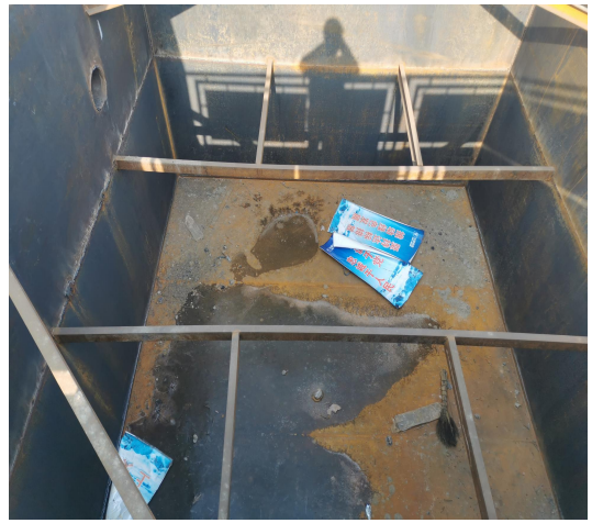
钢制渗滤液收集池
