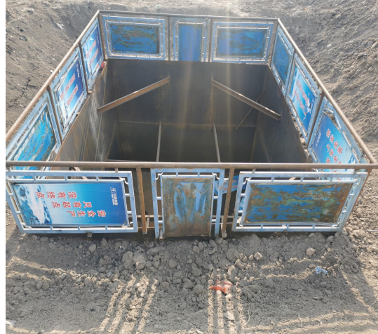
钢制渗滤液收集池
