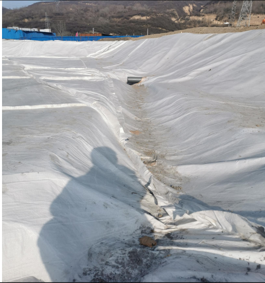
渣场东侧截洪沟以及连接钢管
